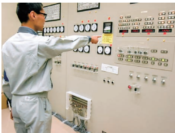
【写真1】制御盤の前で計器類の監視を行う操作班作業員
